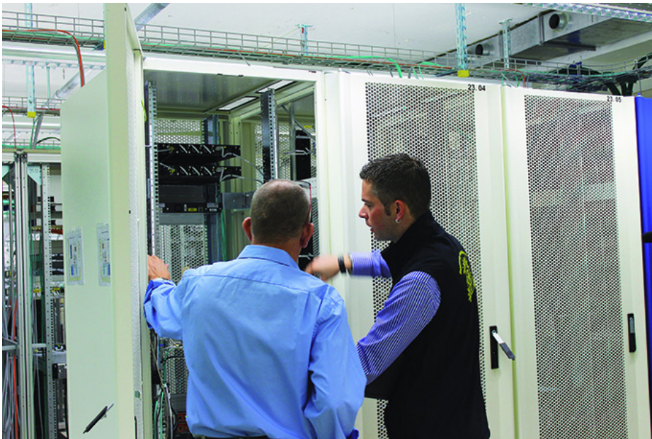
Die Rechenzentrumslösungen von brüco laufen in der Schweiz bei vielen großen Kunden wie zum Beispiel Banken und Versicherungen, der Post, der Armee und in vielen Bundesämtern.
